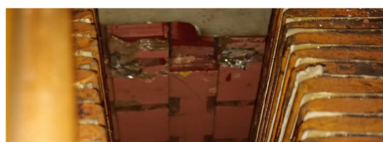
Figura 1. Fallas en las bobinas 105 y 106 del estator (arriba), daños en el núcleo del estator (abajo) de la U1 de la central Baba
