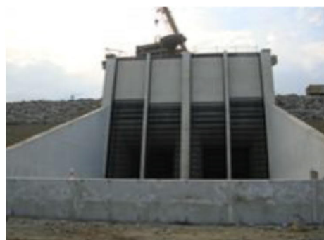
Figura 1. Toma de carga y rejas (Dique 4), previo al llenado del embalse Baba
