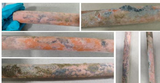
Figura 1. Tubería de polietileno deteriorada
