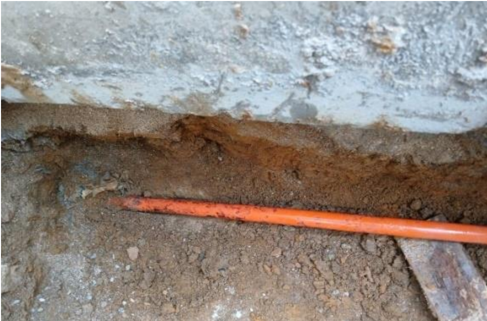
Tubería de polietileno de media densidad (PEMD) de la Zona Andina de Colombia 39 años de servicio
