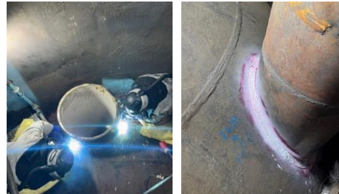
Ductos ascendentes R-4201
