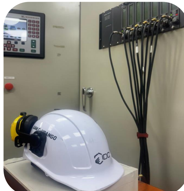
Registro de Vibraciones relativas desde sistema de protección
