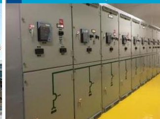
Alineación Interruptores MT
