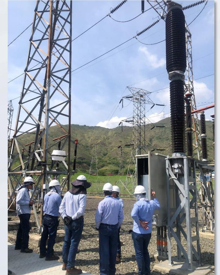
PFI Patio conexiones subestaciones ISA-INTERCOLOMBIA
