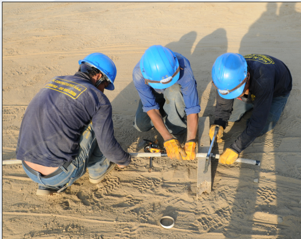
Extracción de muestras de cable para pruebas de laboratorio
