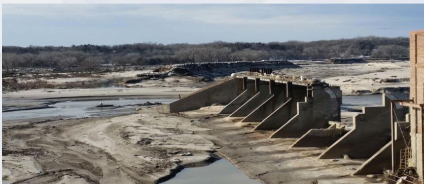
Spenser Dam(2019) (EEUU) – 1 muerte Avenida torrencial Hielo – falla en compuertas
