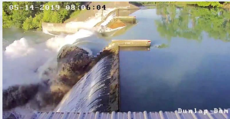
Dunlap DAM (EEUU) (2019) – 0 muertes Envejecimiento de acero de compuerta
